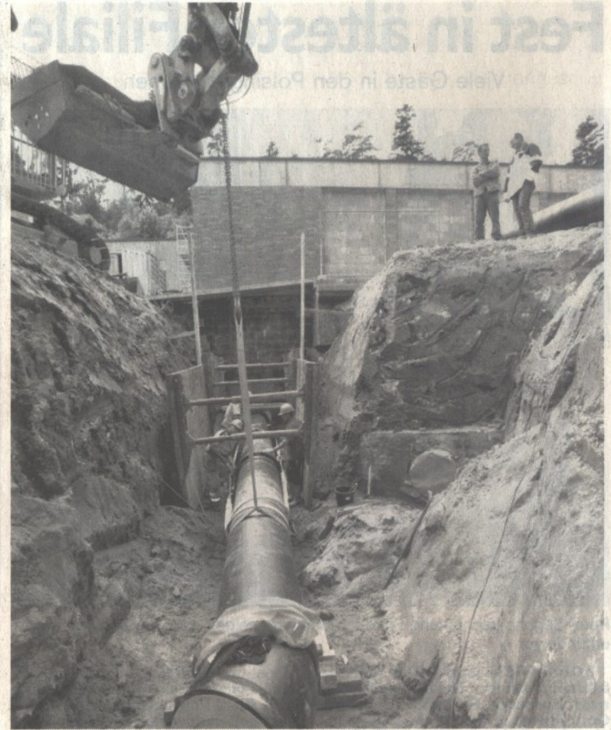
Ohne Störungen wurde jetzt auch die Zu- und Ableitung zum Hochbehälter nahe Mittleschenbach erneuert und in das Leitungssystem eingebunden.
