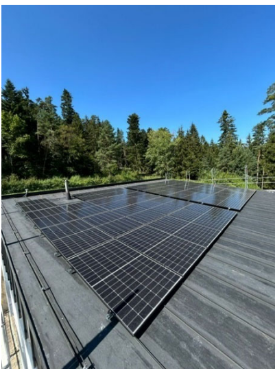
Installation der 3 Anlage auf dem Dach des Hochbehälters Mitteleschenbach August 2024; Kosten ca. 25.014 EUR
