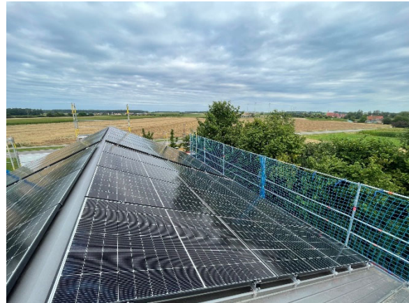
Neu errichtete PV-Anlage auf dem Dach des Pumpwerks Wolframs-Eschenbach
